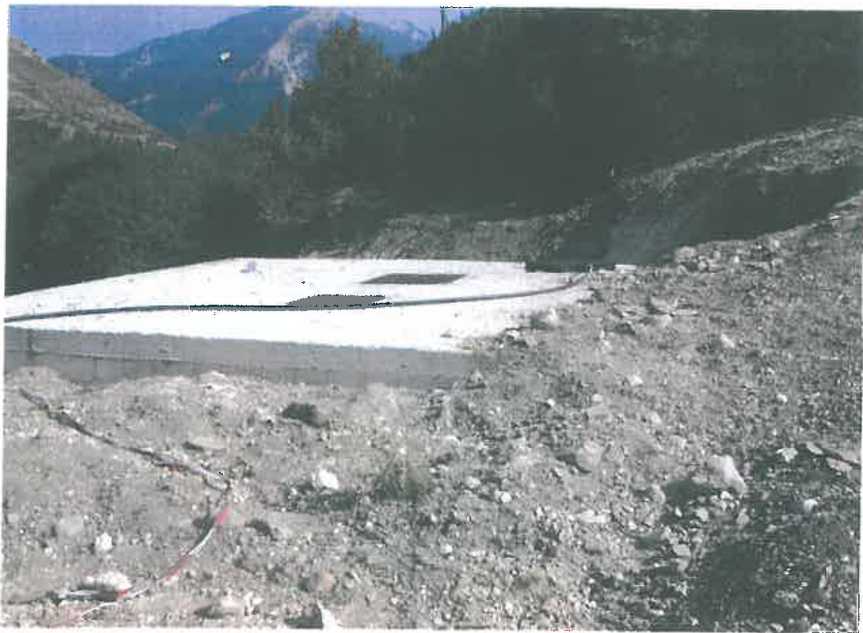
Foto n. 5 - Realizzazione pozzi N.6 e N.7 del campo S.Rocco a Bussi sul Tirino.
