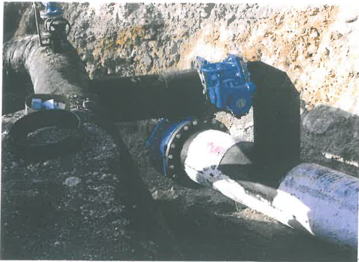
Foto n. 4 - Raddoppio in galleria Bussi condotta adduttrice Giardino. Particolare valvola di intercettazione sulla tubazione.
