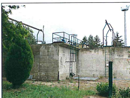
F.1: Vasche di ossidazione e di stabilizzazione fanghi di supero
