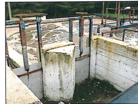
F.5: Vasche di stabilizzazione fanghi
