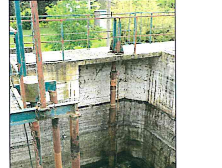
F.8: Bacino di stabilizzazione fanghi
