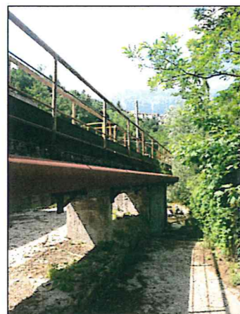
F.8: Canale adduzione liquami all'ossidazione
