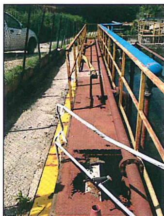
F.7: Passerella vasca di degestione aerobica
