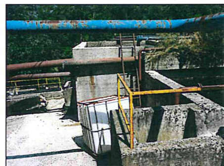
F.2: Vasca di degestione aerobica fanghi
