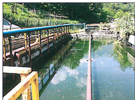
F.1: Vasca di degestione aerobica fanghi
