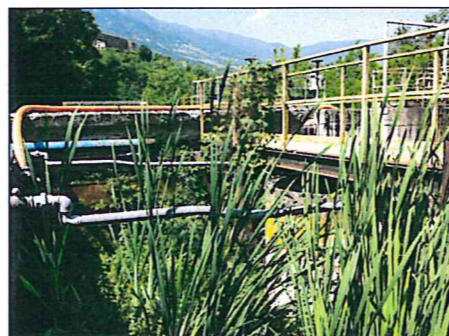
F.3: Vasca di sedimentazione pluviali
