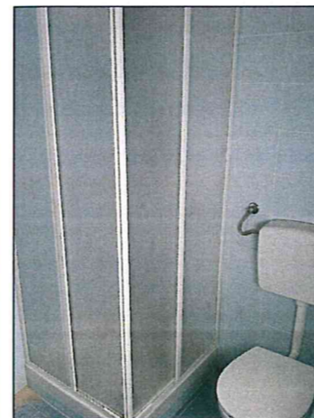
F.5: Servi igienici - locale servizi
