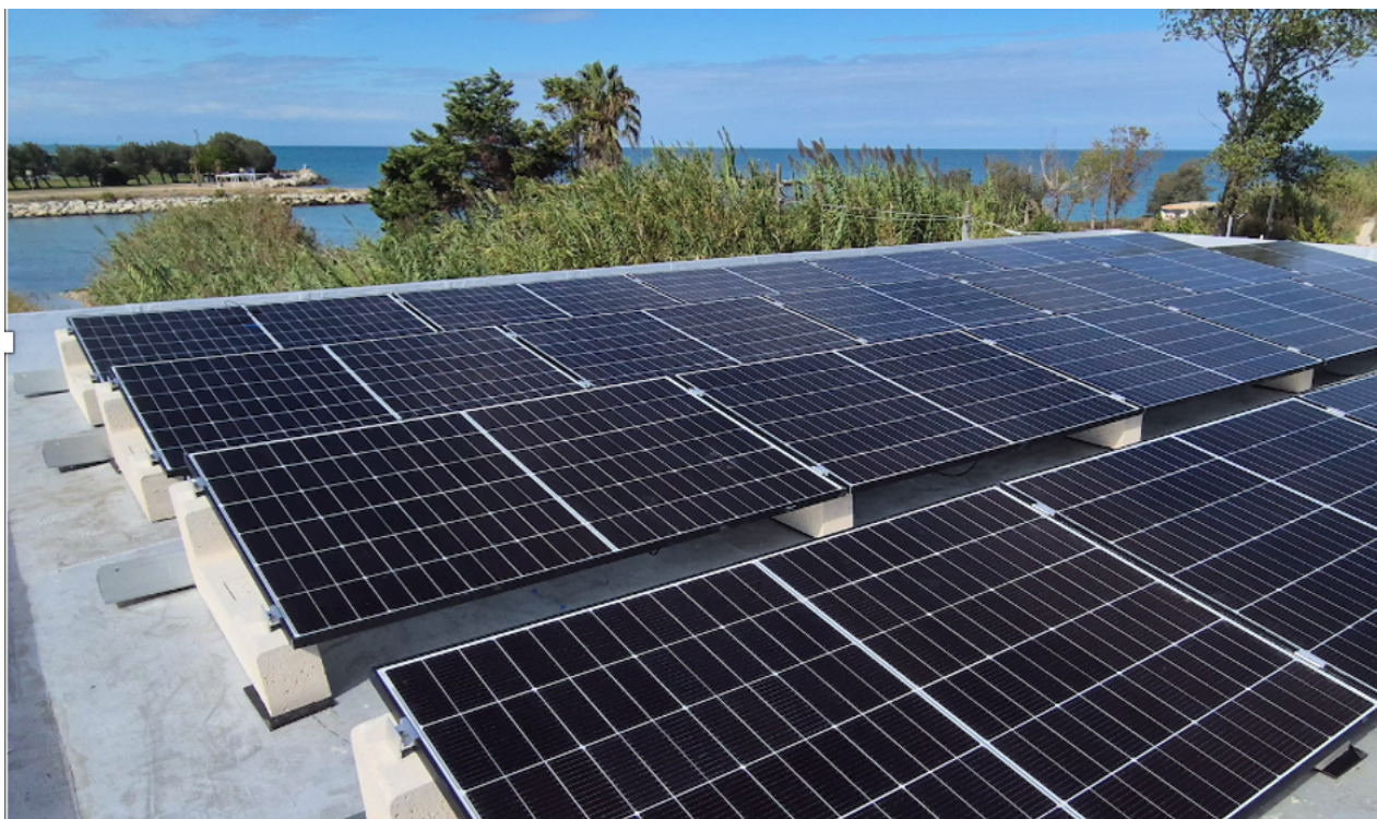
Impianto fotovoltaico di Montesilvano
